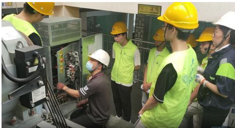
图 3-1 重庆能源职业学院企业导师、学校教师在电梯机房指导学生 对电梯控制柜进行维保检修和调试工作
